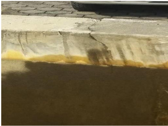
Estado de Paredes del Filtro
