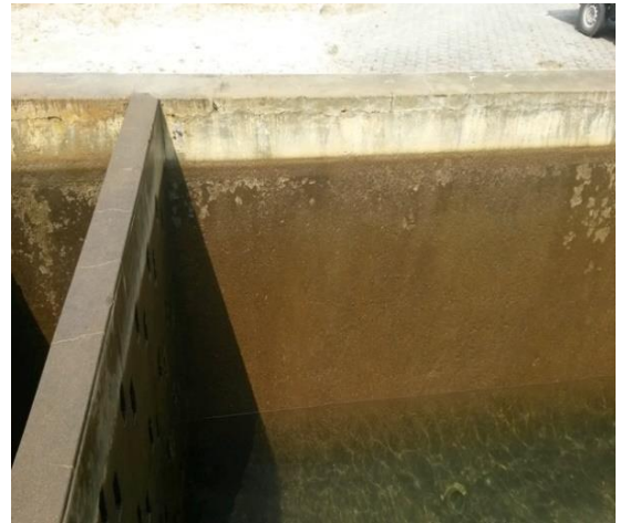
Estado de Paredes del Sedimentador
