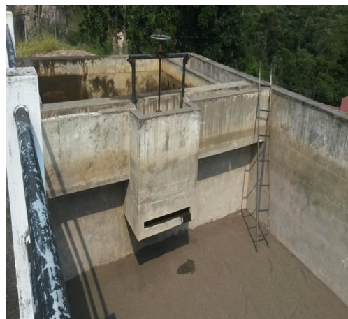
Cámara de Entrada del filtro Lento
