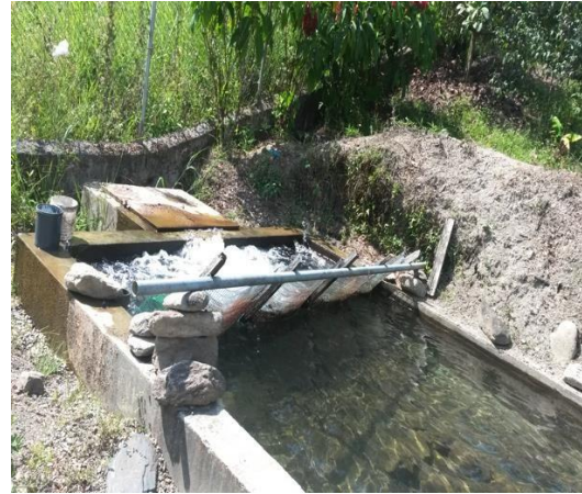
Malla para Evitar Deterioro del lecho filtrante
