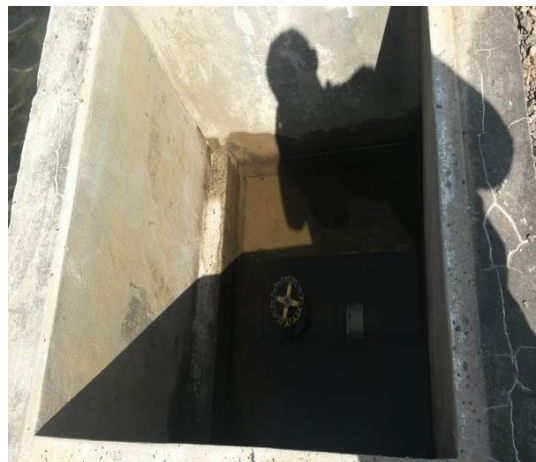
Cámara de lavado Hidráulico del filtro
