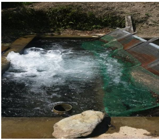
Rebose del agua en cámara de entrada
