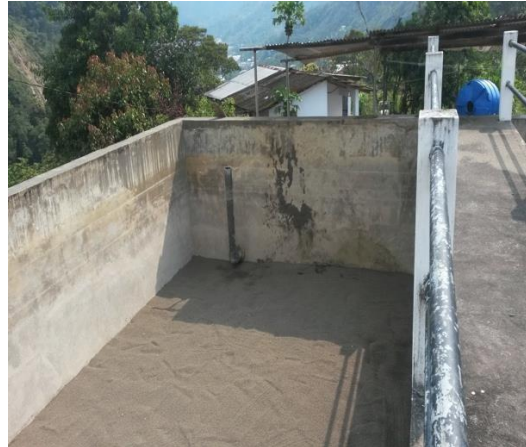
Lecho filtrante de arena del filtro lento
