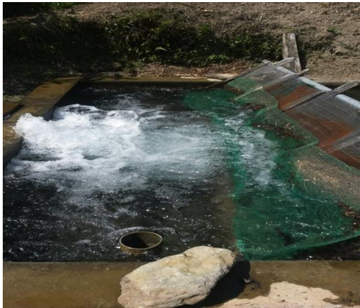
Rebose del agua en cámara de entrada
