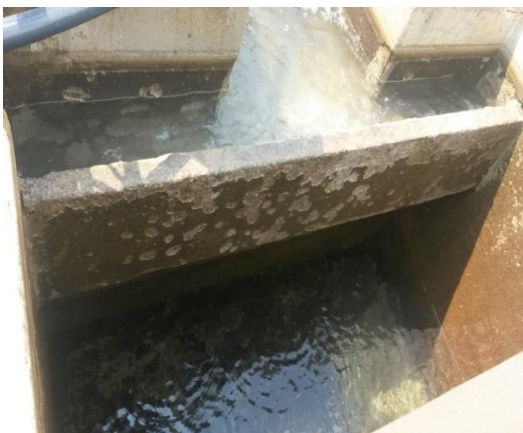
Estado de paredes del canal de entrada de la planta
