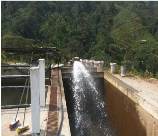
Entrada del agua Cruda a la planta
