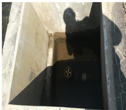
Cámara de lavado Hidráulico del filtro
