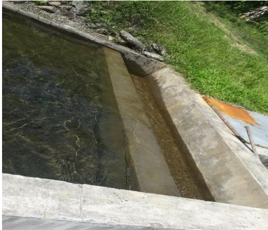
Vertimiento de Excesos en cámara de Salida durante la Operación del filtro
