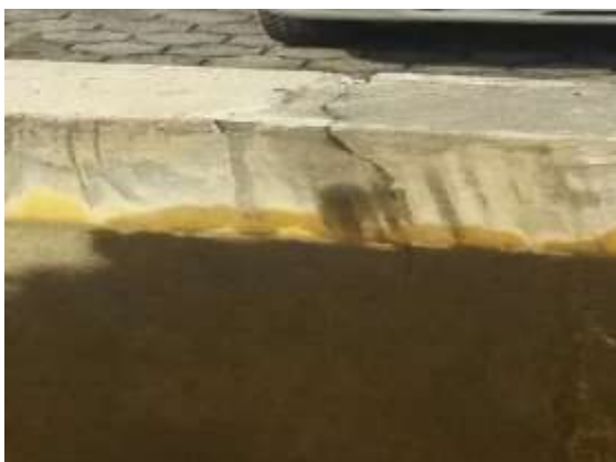
Estado de Paredes del Filtro
