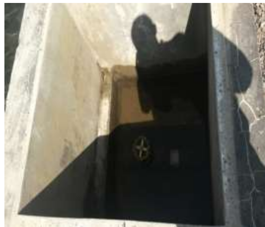
Cámara de lavado Hidráulico del filtro
