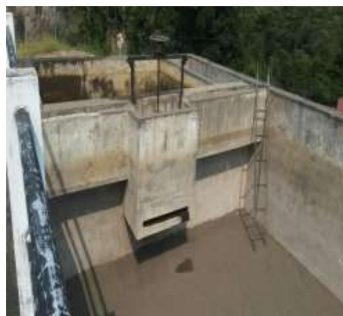
Cámara de Entrada del filtro Lento
