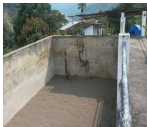
Lecho filtrante de arena del filtro lento
