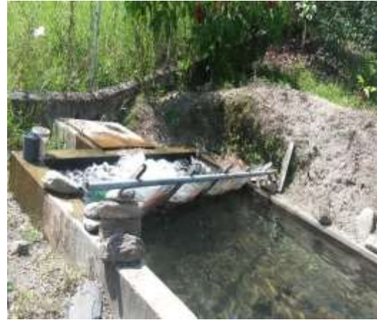
Malla para Evitar Deterioro del lecho filtrante
